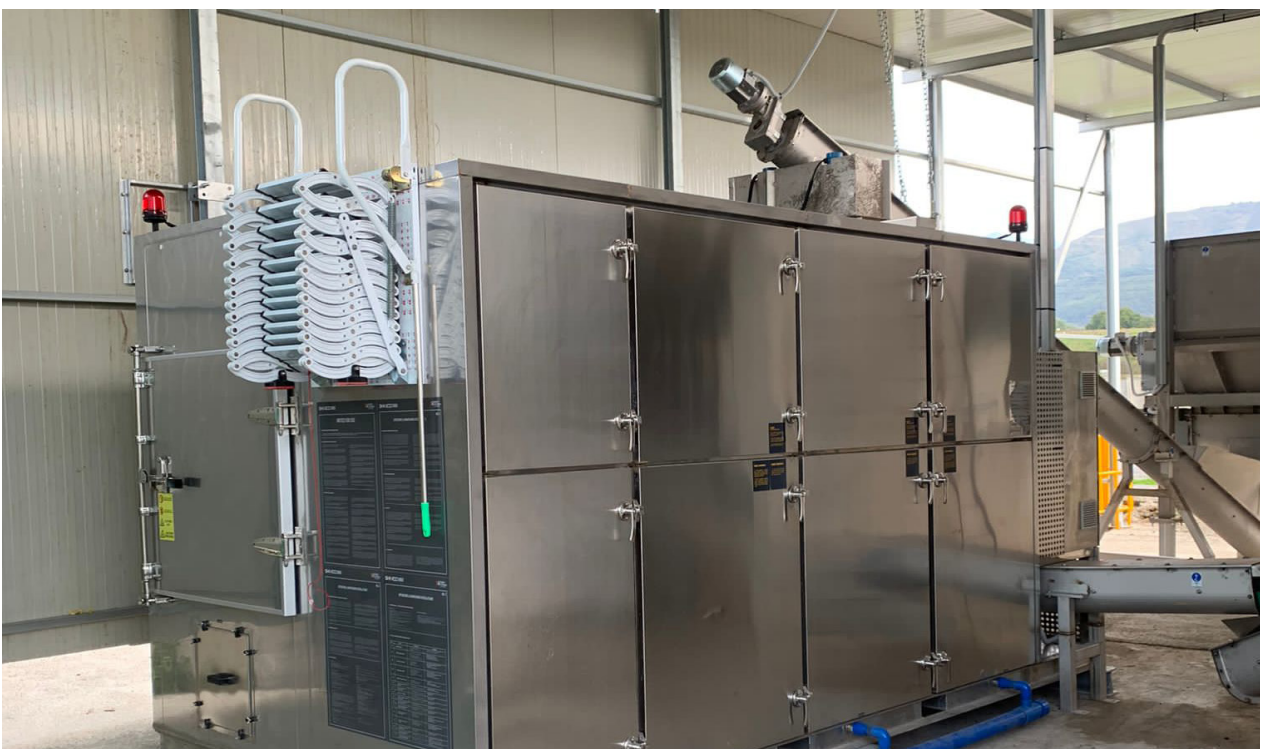
Essiccatore termico fanghi installato presso l'impianto di depurazione di Santa Maria del Cedro
